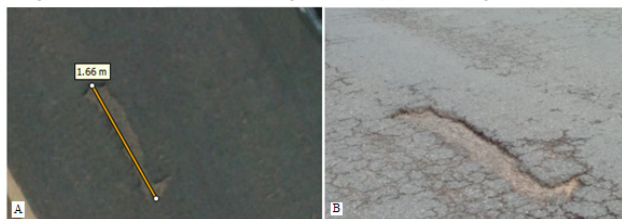
Figura 7 - Levantamento de manifestação patológica tipo desgaste: em (A) vista na imagem, em (B) na fotografia in loco
