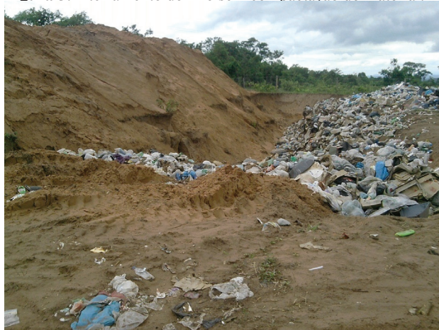
Figura 5: Aterramento do lixo sem compactação do material.
