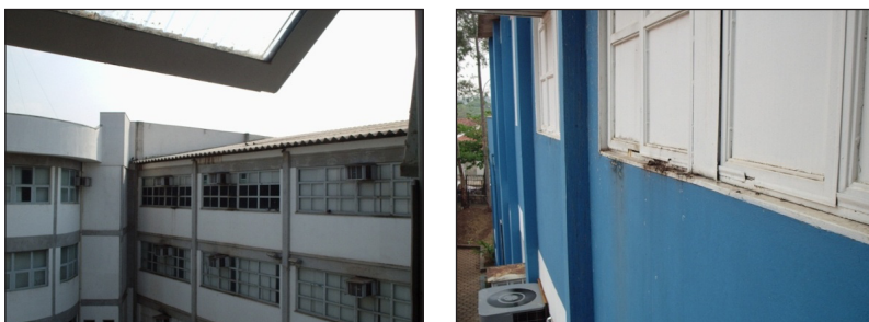
Figura 9 – Parede e janelas com fezes de pombo no bloco E.
