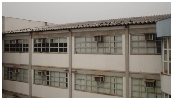
Figura 12 – Pombos no telhado do bloco E
